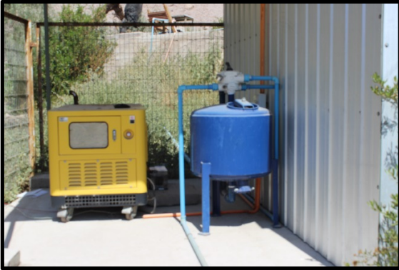
Unidad de generación de electricidad (amarillo) y unidad de filtración de sólidos no disueltos en el agua a procesar.
