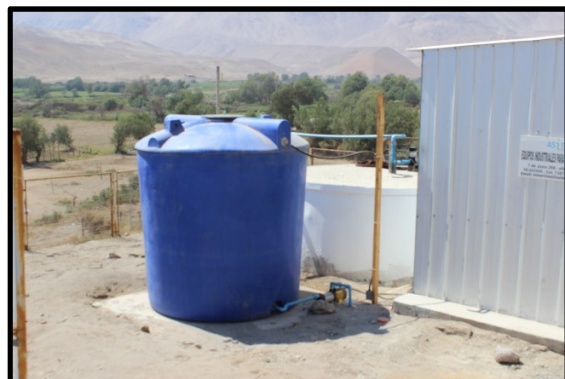
Estanque de acumulación del agua purificada; tubería superior que alimenta al estanque; bomba impulsora del agua para regeneración.
