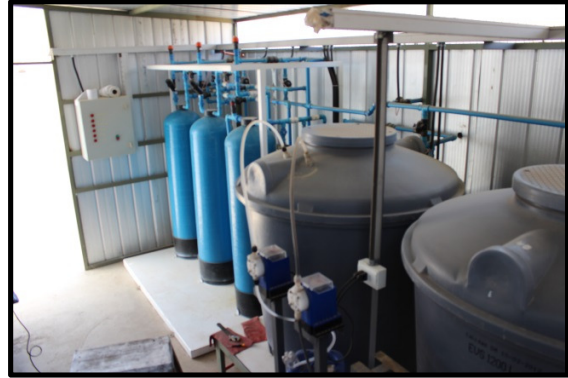
Columnas con resina activa en su interior para la adsorción del Arsénico (azul claro); sensores y reguladores de flujo entre la red de tuberías superior; estanques de preparación de soluciones de regeneración (gris); bombas para líquidos corrosivos y cáusticos (azul oscuro).
